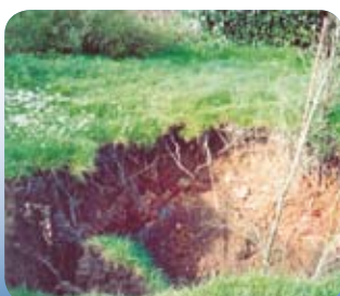
Effondrement de marnière
